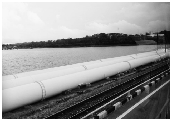
マレーシアから伸びるパイプライン
